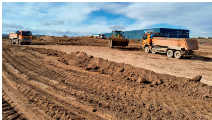
Imagen de las obras del nuevo complejo de Igoa y Patxi en Plaza (Zaragoza).
