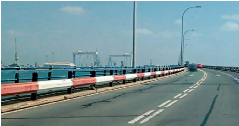
El deterioro de las carreteras provoca incrementos de costes en las empresas del sector.
